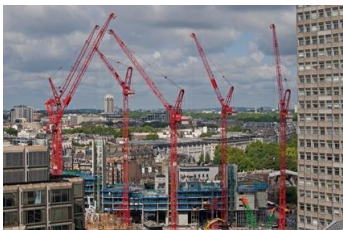
HTC nennt über 200 WOLFF Krane ihr Eigen. Nach der Übernahme umfasst die Flotte des Heilbronner Premiumherstellers WOLFFKRAN nun rund 750 Krane. Auf dem Bild arbeitet ein Rudel roter WÖLFFE am Nine Elms Redevelopment.
